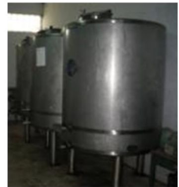
Cuve de stockage en Inox
